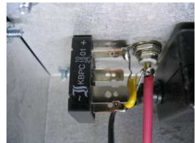
BNC-Eingangsbuchse von MOPA-Leistungsverstärker (Fa. GB 4000) für die Rife-Frequenzbehandlung mit zus. Brückengleichrichter 1.) als Schutz für Frequenzgenerator und 2.) zur Leistungssteigerung - durch vergrößerten Duty-Cycle, s. Text: Minus-Anschluß an Eingang und den Plus-Anschluß an Masse!
